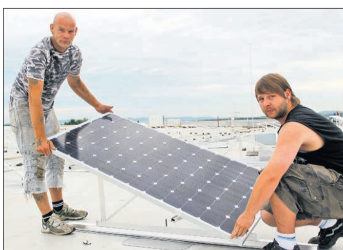
Sauberer XXXL Strom: Auf dem rund 4.500 Quadratmeter großen Dach des neuen XXXL Möbelhauses in Freiburg werden insgesamt 1.100 dieser Module für die Photovoltaik-Anlage angebracht. Jährlich werden so in etwa 270.000 Kilowattstunden Strom erzeugt.
